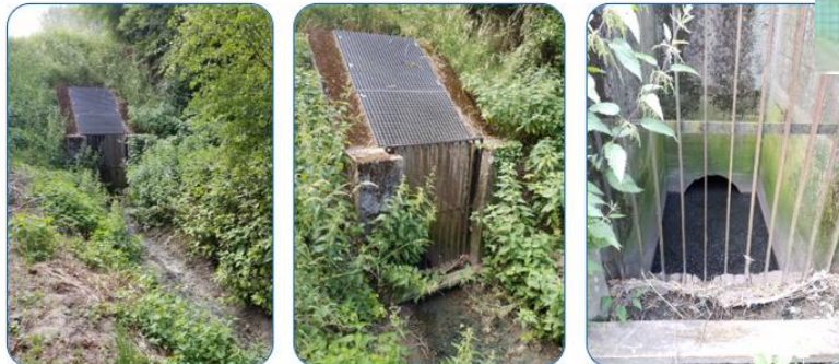
Illustration 3. Tête amont du siphon sous le CDN à Catigny
