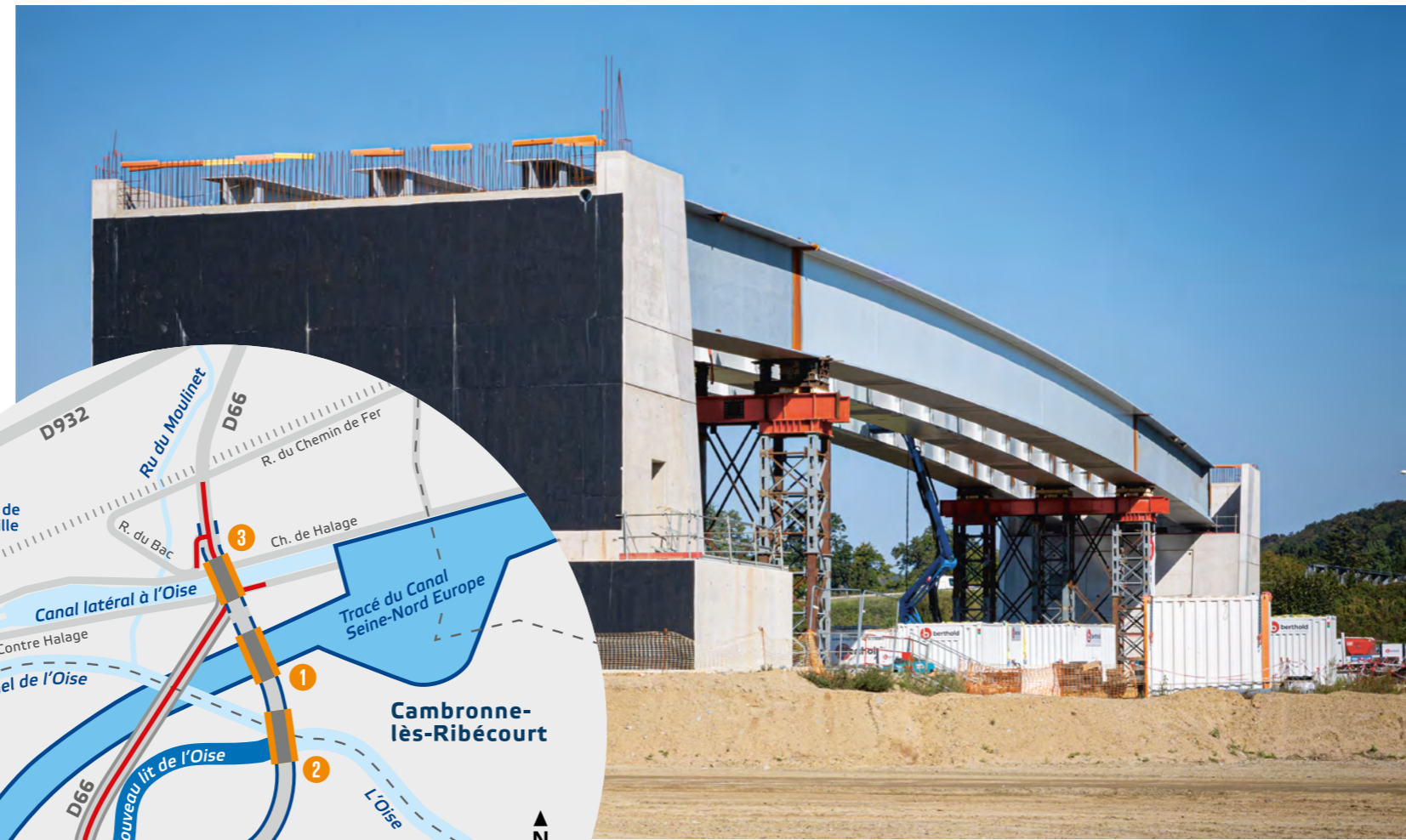
La charpente du pont de la RD 66 sur le futur Canal à Montmacq est entièrement posée, septembre 2023 © J.-C. Hecquet / SCSNE
