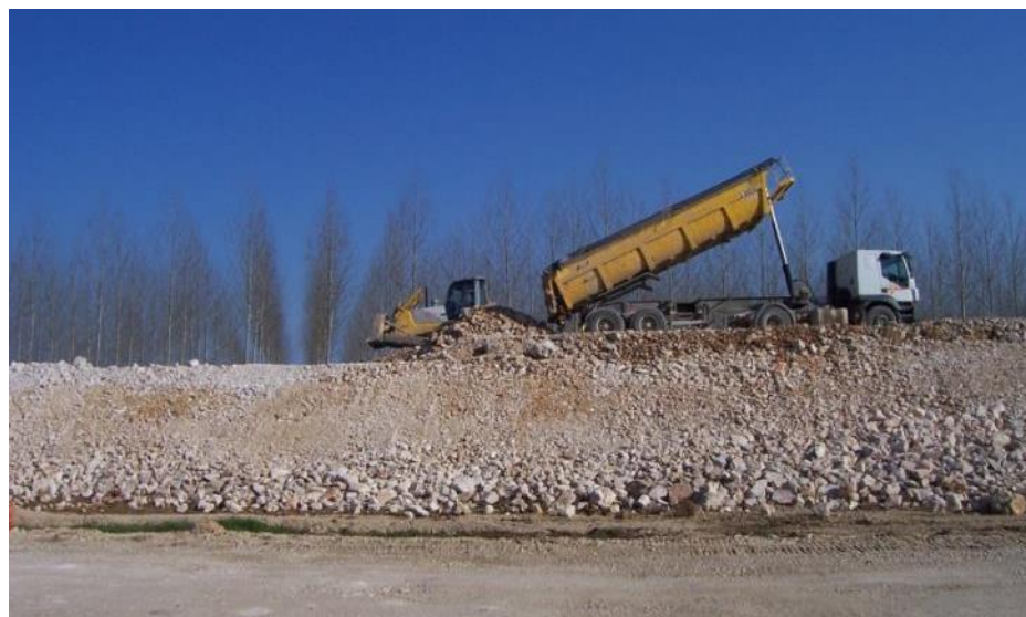
Photo 7 : Mise en œuvre de matériaux de préchargement (Source : chantier LGV Rhin-Rhône, setec)
