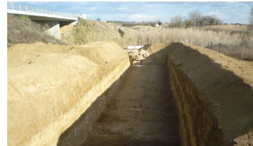
Photo 9 : Bassin de décantation avec filtre à cailloux (Source : chantier élargissement A9, setec)
