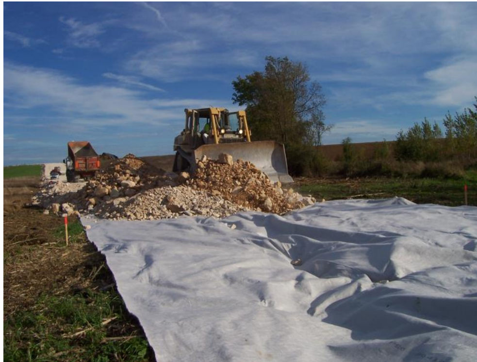
Photo 14 : Mise en place d'un géotextile dans la traversée d'une zone humide (Source : chantier LGV Rhin-Rhône, setec)
